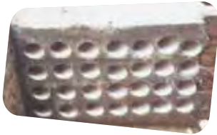
Ducto EB revestido en concreto
